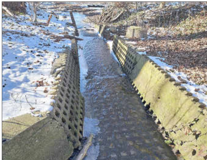
Ein mit Rasengittersteinen verbautes Gewässer. Die Platten sind instabil und im Hintergrund kann man sehen, wie sie bereits ins Gewässer fallen. Zurück bleibt ein ungeschütztes Ufer. Foto: Zinke, LFULG
